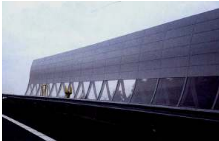
Figura 82 Barreira metálica com painéis transparentes na parte inferior.
